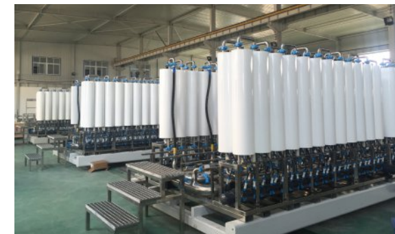
STRO浓盐废水
